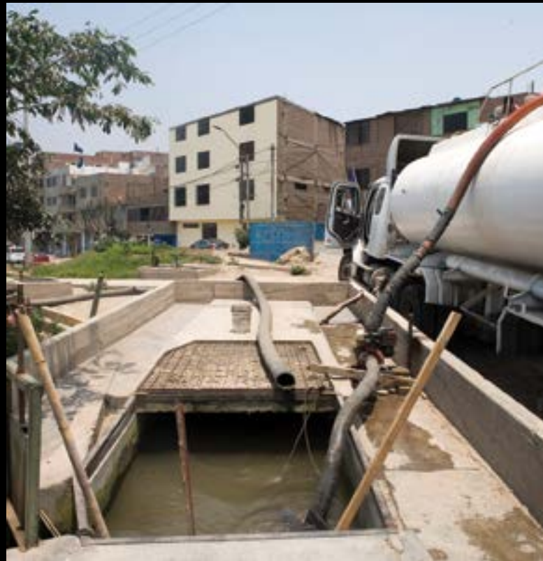
↗ Captación ilegal de cisterna en avenida Huarochirí, Santa Anita.
