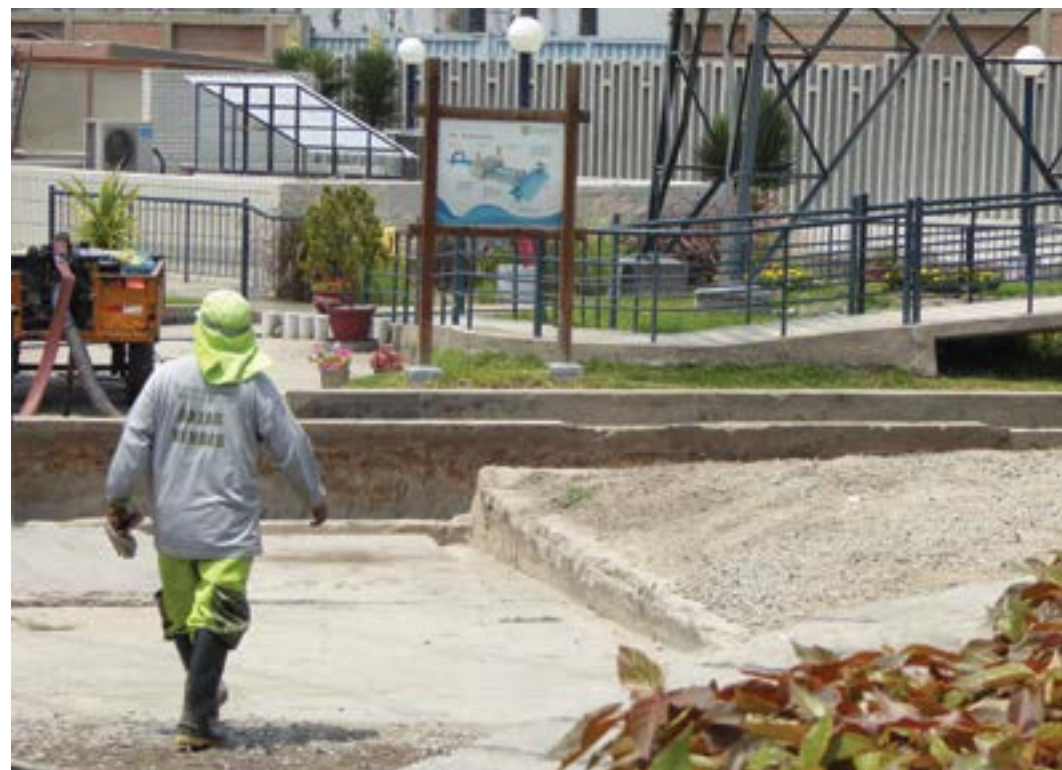
◀ Planta de tratamiento de Surco, en la avenida Intihuatana.
